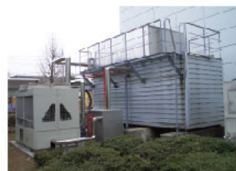
蓄冷工程 (板冰、流态冰)
